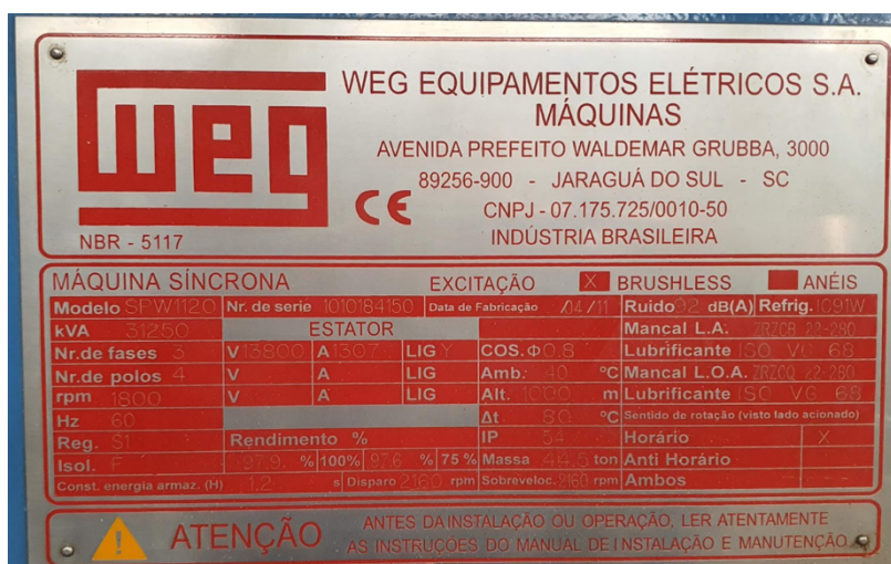
Alternator/ Generator nº 2
