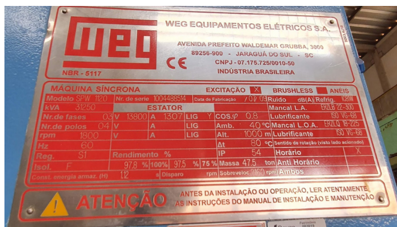
Alternator/ Generator nº 1
